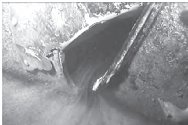
Slika 6: Nasilno izvedena odprtina v cevi natege s slike 5.
